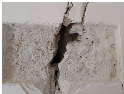
Detalle grieta (2004) enfoscado (2006)
