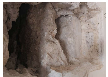
Detalle grieta (2004) enfoscado (2006) y muro de yeso encofrado (2007)
