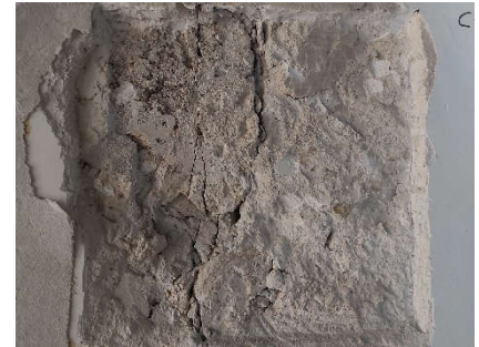
Detalle grieta (502) y el repellado (503) de mortero que la rellena
