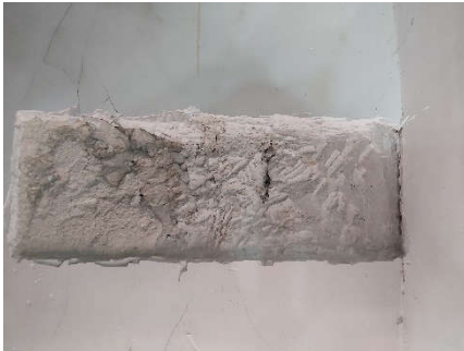
Vista general muro tapial (2705), grieta (2703) repellada con yeso (2704) y muro de yeso encofrado (2706)
