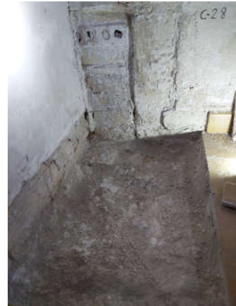
Vista general después de levantar el suelo hidráulico (600) y el mortero de cemento (601)
