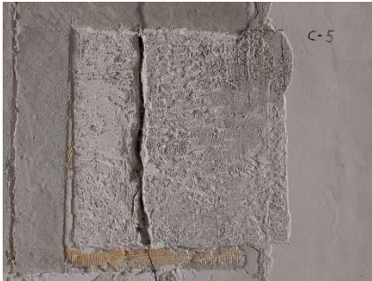
Vista general grieta (502) y los diferentes enlucidos
