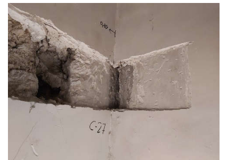
Detalle unión muros de yeso encofrado (2706 y 2707) en ángulo, sin trabar
