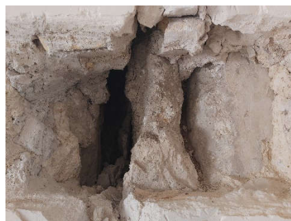
Detalle grieta (2004) y muro de yeso encofrado (2007)
