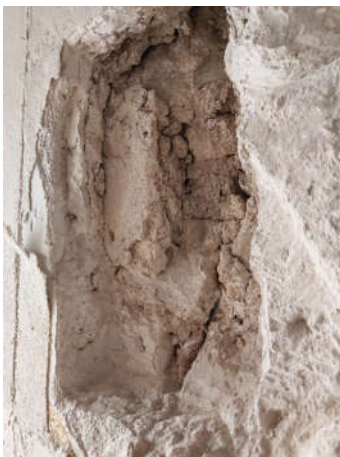
Detalle costra del tapial (507)
