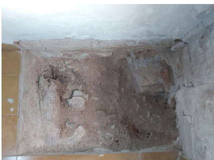
Detalle forjado (603) y mocheta (604)
