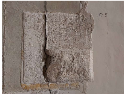
Vista general grieta (502) y los diferentes enlucidos
