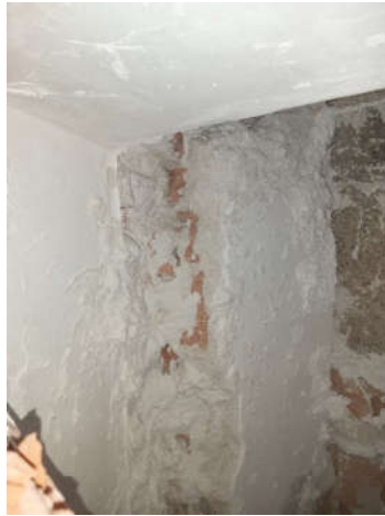
Detalle vano (1805), cámara hueca (1804), tabique ladrillo (1806) y recrecido tabique con losa de terrazo (1807)
