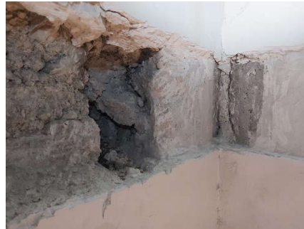
Detalle grieta (2703), muro tapial (2705) y muros de yeso encofrado (2706 y 2707) en ángulo
