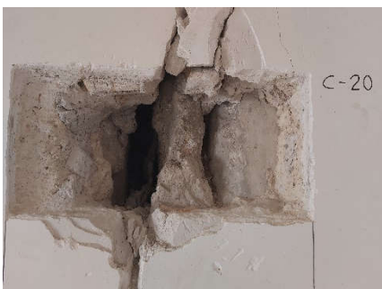
Detalle grieta (2004), tirante (2003) y muro de yeso encofrado (2007)
