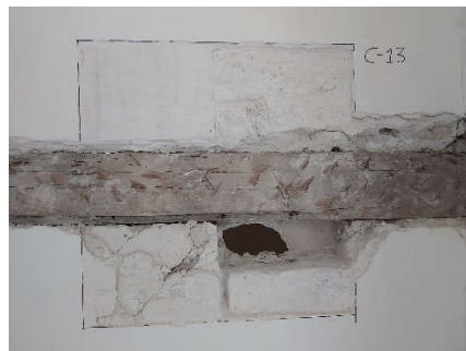
Vista general viga (1303) y muro de yeso (1304) perforado de modo accidental. Detrás hay un armario empotrado
