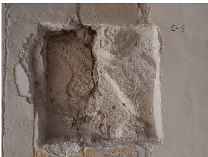
Vista general con los dos tipos de fábrica, mampostería (506) y tapia (507) con costra
