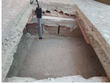
Detalle pavimento de terrazo (1400), baldas de ladrillo (1401), tabiquillos de ladrillo hueco (1403) y solera de cemento (1404)
