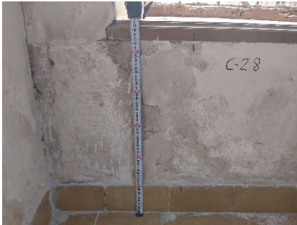
Vista general enlucido (2800)
