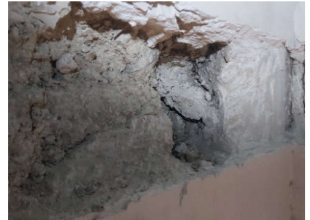
Detalle grieta (2703), muro tapial (2705) y muro de yeso encofrado (2706)
