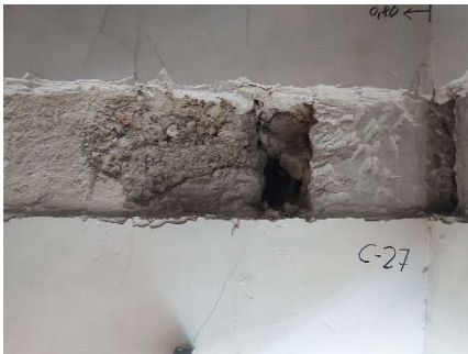
Detalle grieta (2703), muro tapial (2705) y muro de yeso encofrado (2706) de fachada
