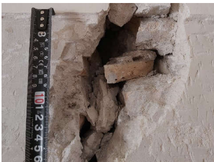
Detalle grieta (2004) y la obra de relleno (2005)
