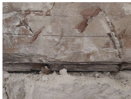
Detalle viga (1303) picoteado, entalladura y clavos de forja
