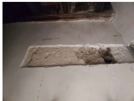
Detalle de la altura con respecto al forjado de la ubicación del vano del grabado del siglo XIX, ocupado por el muro de tapial (2705)
