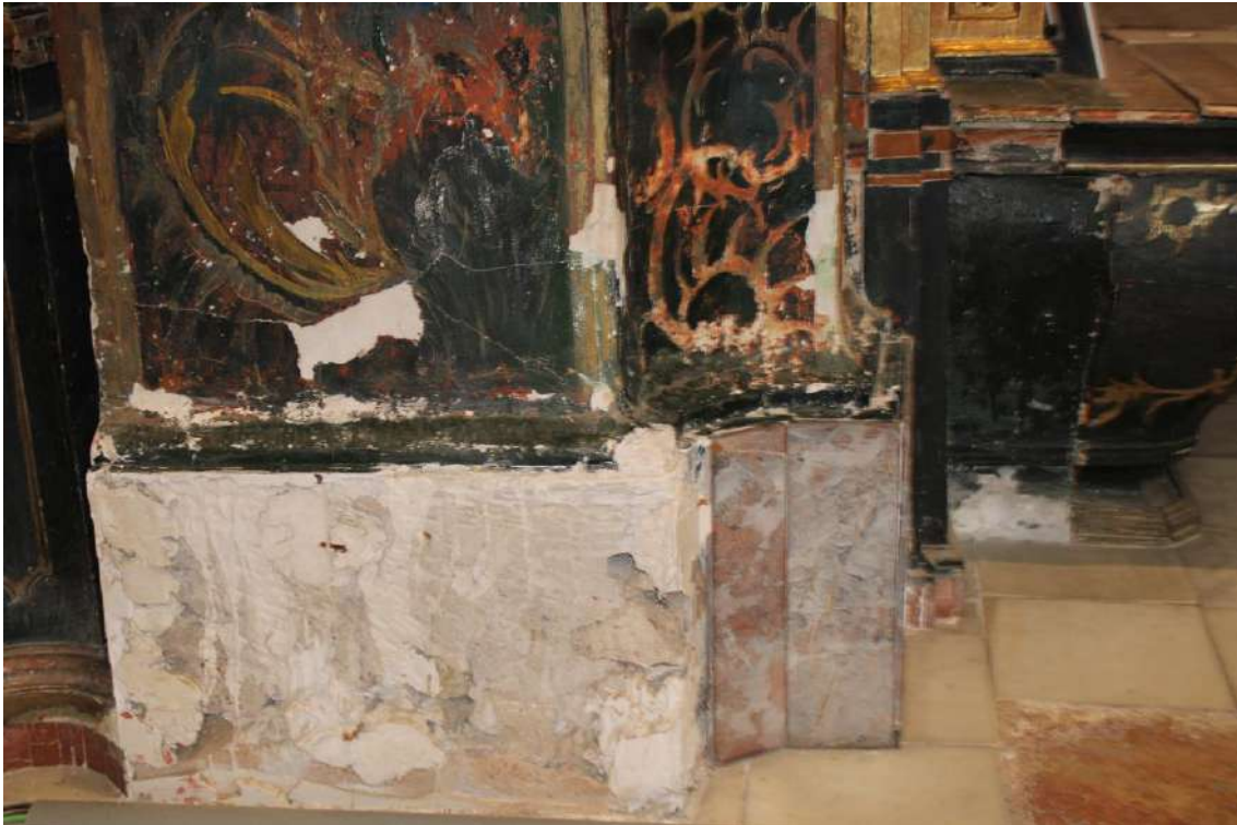
Figura 22; Parte baja de uno de los pilares de la iglesia del templo
