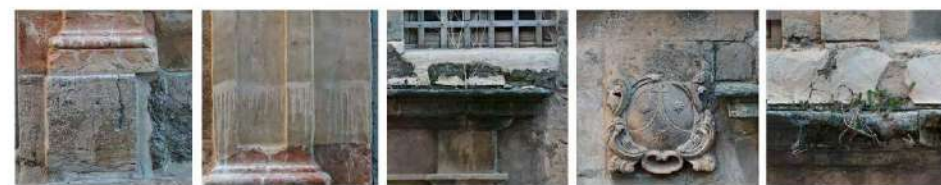
D1: Falta de material. Erosión y parches. D2: Manchas. D3: Costra negra, erosión de cornisa pétreo y de pendiente de mortero. D4: Erosión y rotura del emblema carmelitano. D5: Rotura de cornisa y colonización vegetal.
