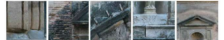
D6: Erosión y parche de cemento. D7: Costra negra que se extiende al ladrillo. D8: Erosión y piezas del frontón sujetadas con grapa metálica. D9: Erosión y proliferación de vegetación. D10: Marcas de limpieza no exhaustiva.
